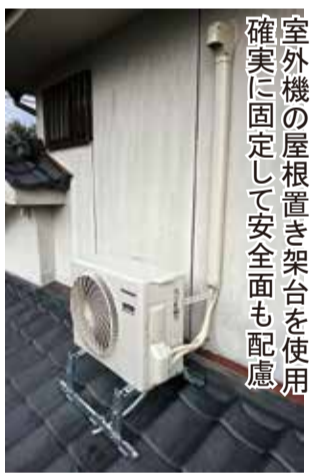
どうしても室内を通さないとはいけなく化粧カバーですっきり配管
